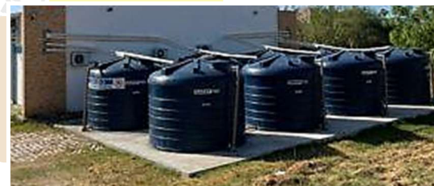
FIGURA 74 - SISTEMA DE REUSO DE ÁGUAS PLUVIAIS DO COMPLEXO TPA DO CAMPUS MOSSORÓ-RN
