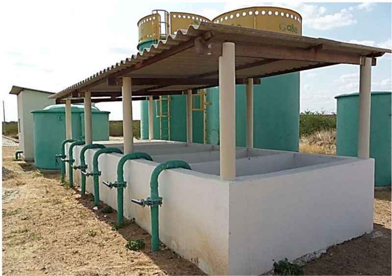
FIGURA 75 – ESTAÇÃO DE TRATAMENTO DE ESGOTO DO CAMPUS CARAÚBAS
