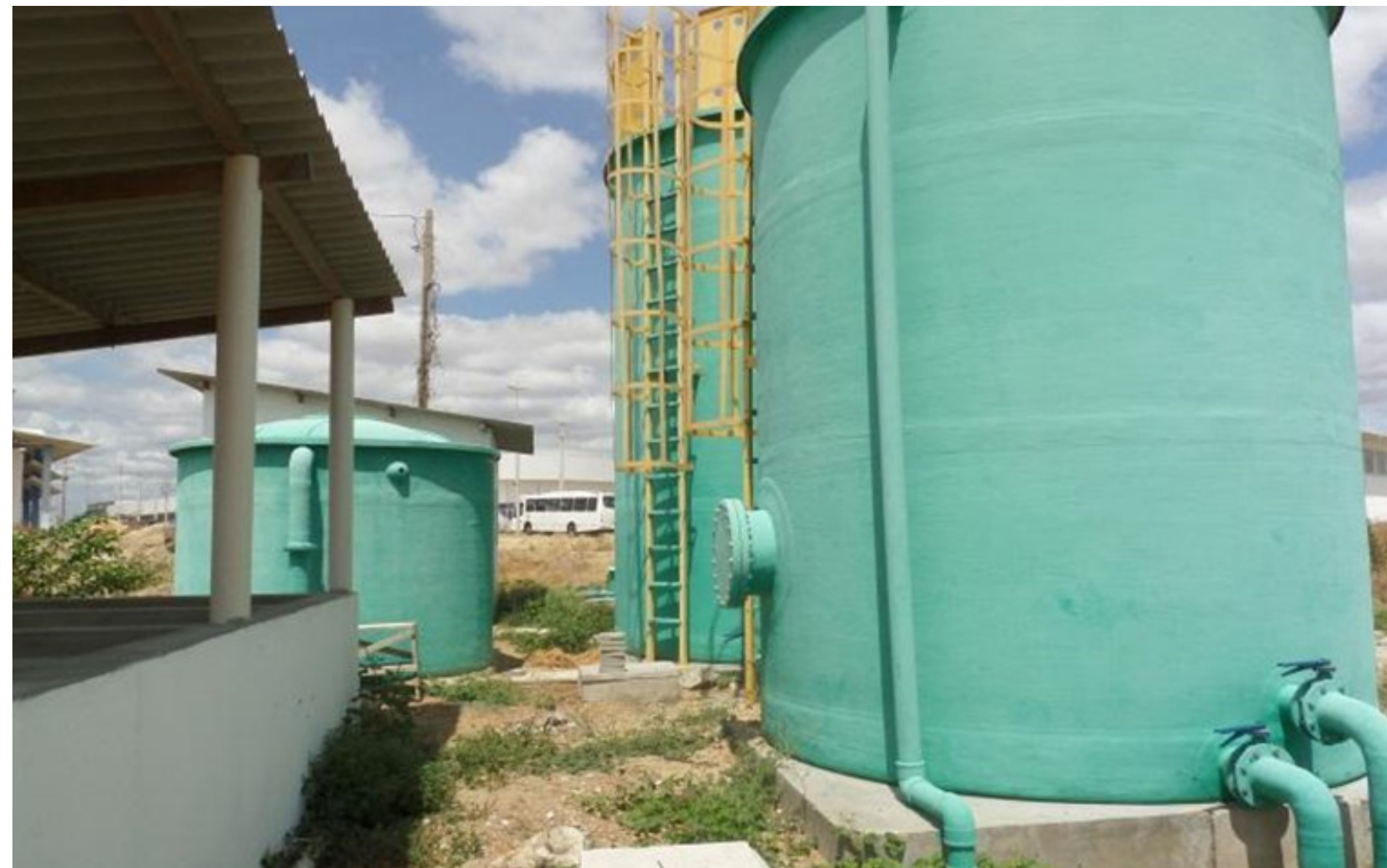
Figura 52 - Estação de tratamento de esgoto do Campus Pau dos Ferros
