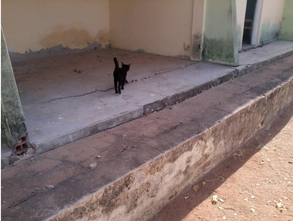
FOTO 6 – Rachaduras em Piso
