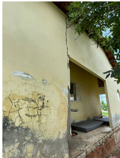
Figura 4 – Aberturas na alvenaria externa
