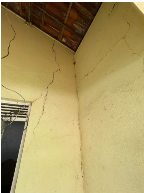
Figura 3 – Aberturas na alvenaria
