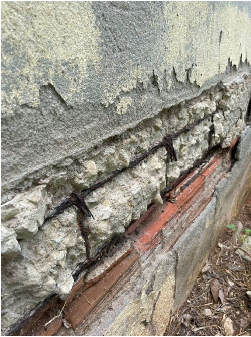
Figura 5 – Laje de piso danificada
