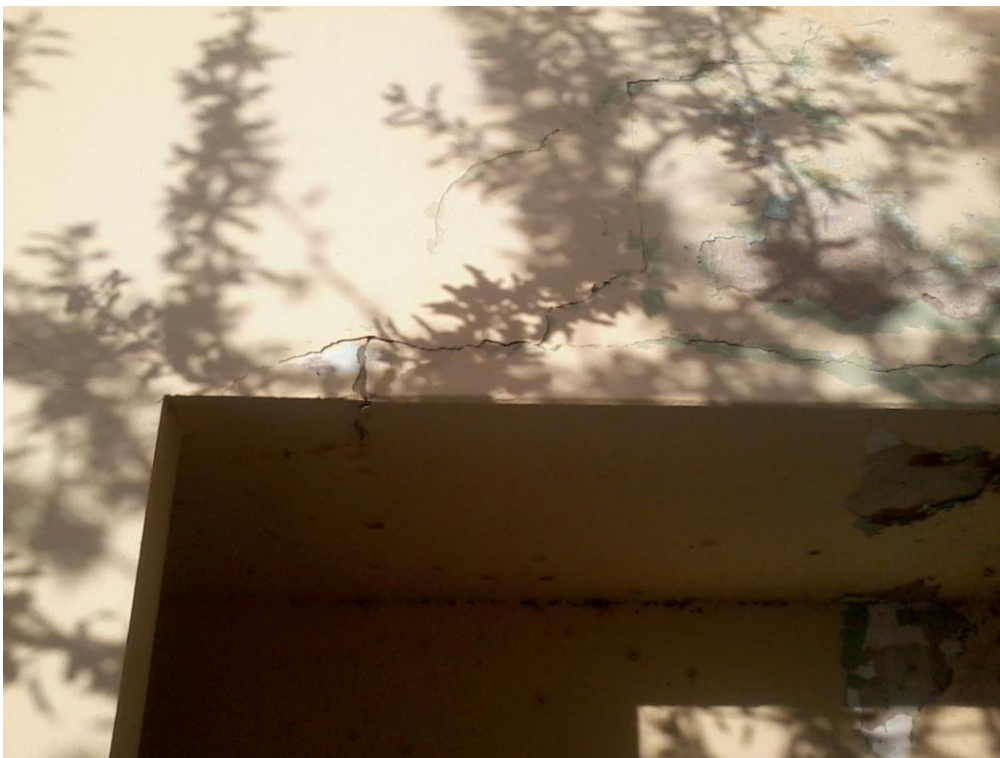
FOTO 7 – Fissuras na pintura
