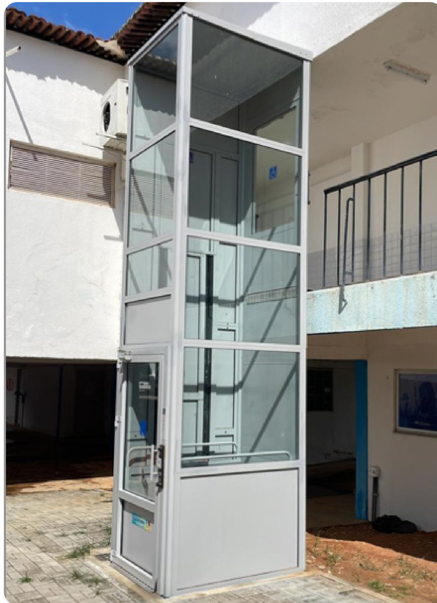
Figura 54 Plataforma de acessibilidade no Prédio Central em Mossoró.
