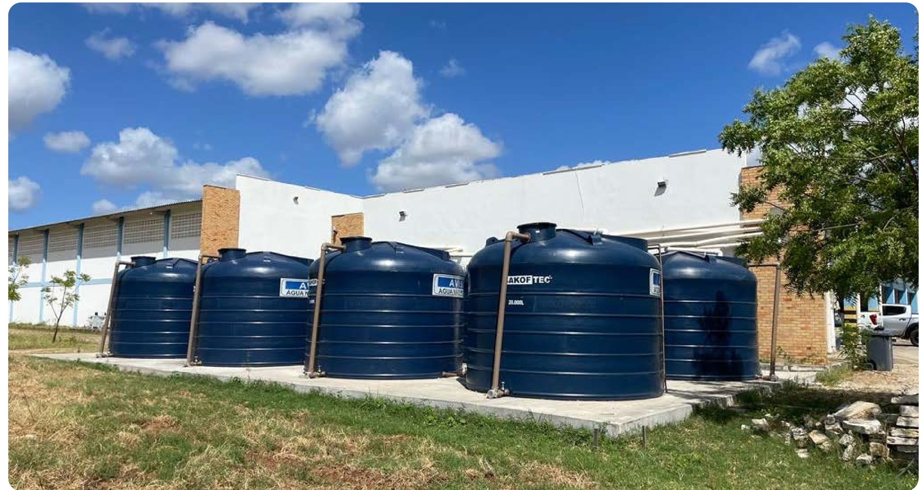
Figura 50 Sistema de reuso de águas pluviais.
