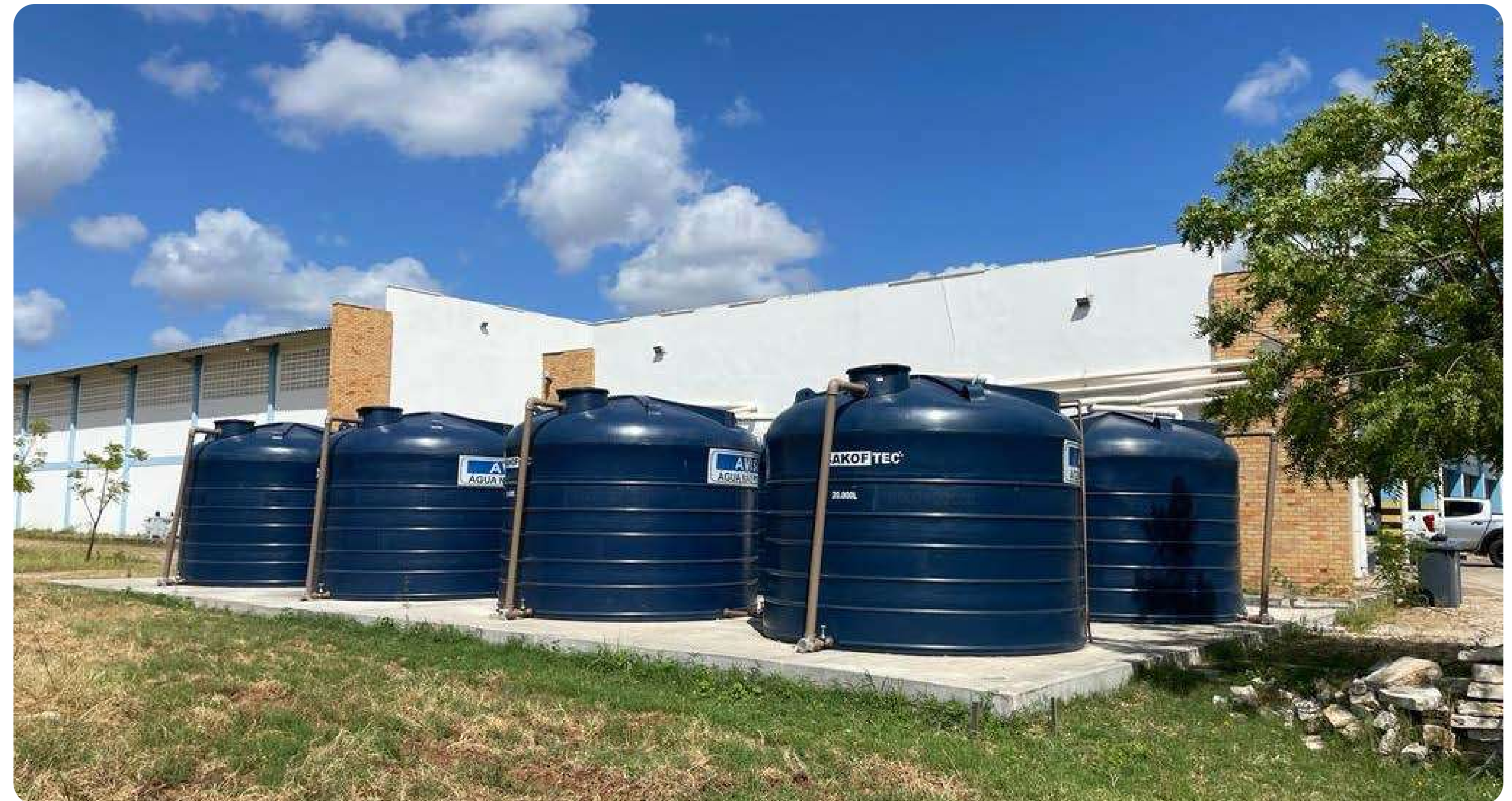
Figura 50 Sistema de reuso de águas pluviais.
