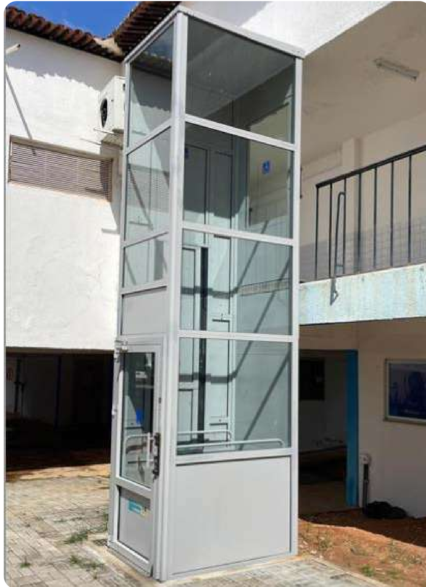
Figura 49 Plataforma de acessibilidade no Prédio Central em Mossoró.
