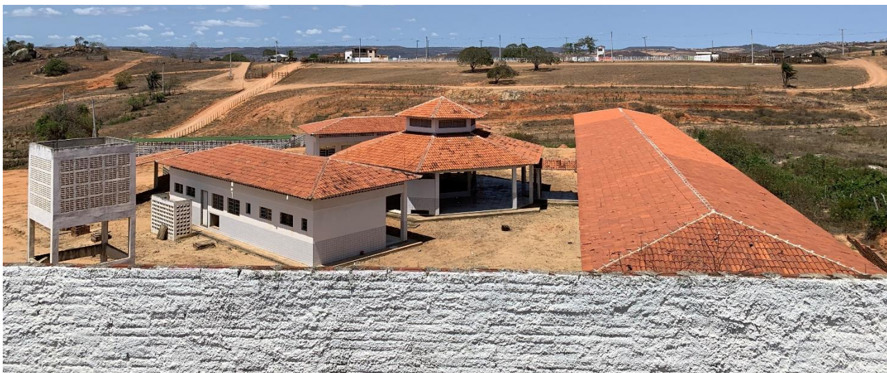
Figura 2 - Vista superior das quatro construções civis e estrutura para reservatório superior de água fria.
